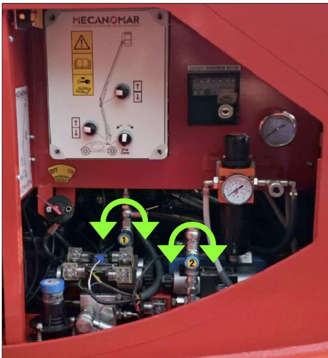
Foto 19: Bajada de emergencia mandos auxiliares
